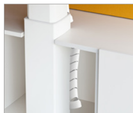
Subida cables PE.
